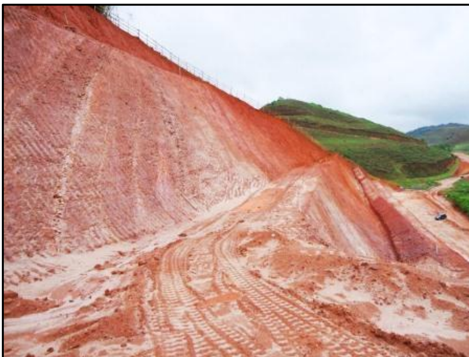
Implantação do mineroduto Minas-Rio. Trecho próximo a Ponte Nova – MG. Foto ARSantos
