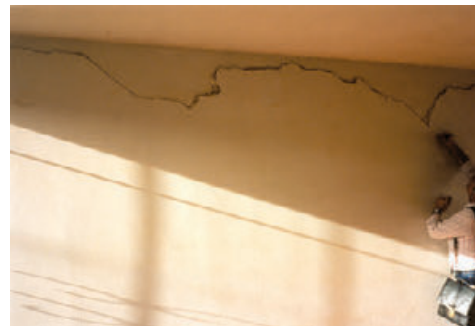
Figura 3 – Rachaduras em uma casa localizada sobre aluviões em Almirante Tamandaré (Foto arquivo José A.U. Lopes)
