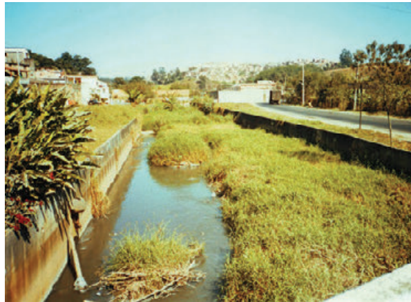
Trecho canalizado do Córrego Cabuçu de Cima, um dos principais afluentes do rio Tietê na Região Metropolitana de São Paulo, com capacidade de vazão totalmente comprometida por assoreamento com sedimentos originários dos processos erosivos nas frentes de expansão urbana. (Foto do Autor)
