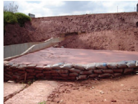
Figura 4 – Dique de sacaria implantado junto à galeria de drenagem, evitando o carreamento de sedimentos para o seu interior. (Fonte: Fernando Kertzman)
