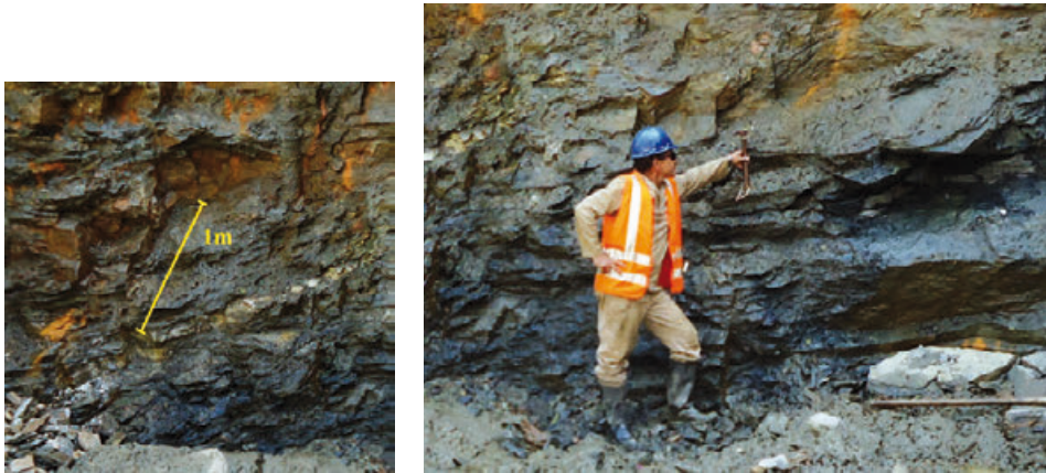
Figura 1 e 2 – Detalhes das frentes de escavação do maciço de fundação mostrando o alto grau de conturbação estrutural, petrológica e intempérica do maciço de fundação. (Fotos do Autor)
