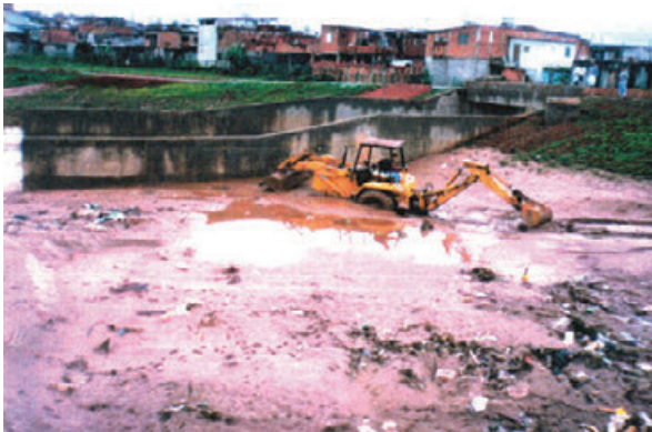
Piscinão do Caaguaçu (Bacia do Aricanduva, SP, Capital) totalmente assoreado por sedimentos originários da expansão urbana. Os piscinões, por constituírem regimes de águas paradas, propiciam também a sedimentação das frações mais finas, siltes e argilas. (Foto do Autor)
