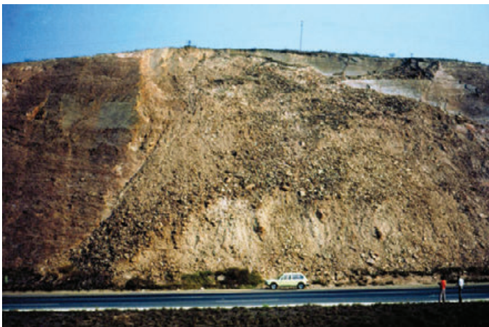
Grande ruptura em filitos provocada pela combinação desfavorável de planos de fraqueza (feições texturais) com o plano de corte do talude e o eixo da rodovia. Rodovia Castelo Branco (SP). (Foto do Autor)
