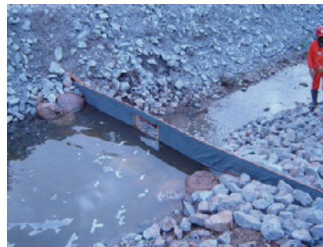
Figura 6 – Barreira com geotêxtil instalada no interior de corta-rio para contenção de partículas finas do solo. (Fonte: Fernando Kertzman)
