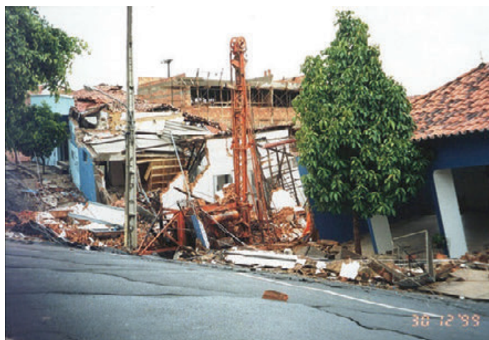
Afundamento cárstico na cidade de Terezina (PI). Notar a presença de torre de poço profundo exatamente no local do afundamento. (Foto de autor desconhecido)
