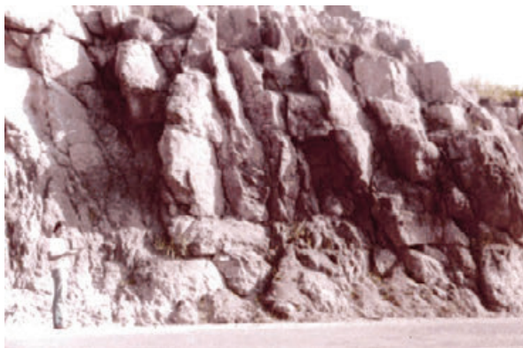
Instabilização de talude em arenito calcífero fraturado provocada pela utilização de explosivos sem o menor critério e cuidados técnicos. Formação Bauru. FEPASA, trecho Bauru–Garça (SP). (Foto do Autor)
