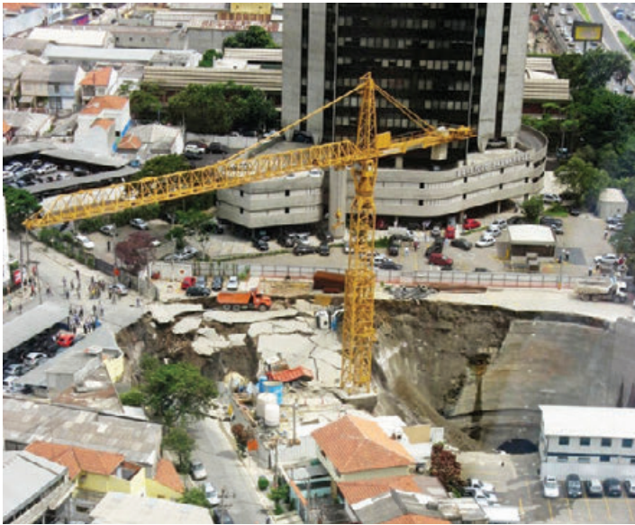
Colapso do túnel da Linha 4 do Metrô paulistano, Estação Pinheiros, em 2007. Muito provavelmente, a boa Geologia e a boa Geotecnia se deixaram sufocar por uma gestão de obra especialmente comprometida em reduzir prazos e custos. (Foto Ana Carmem)
