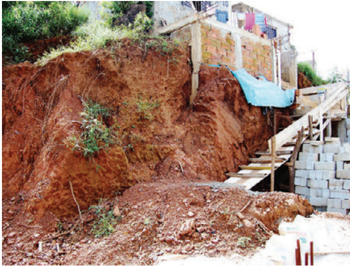
Cena comum: desestabilização de casa já construída pela escavação de lote vizinho. A escavação do lote desestabiliza o terreno superior, pelo corte, e o inferior, pelo lançamento abaixo do material escavado. (Foto do Autor)
